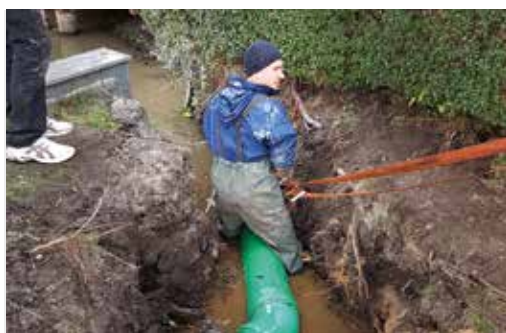
Löschwasser für den Ernstfall
