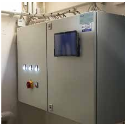
Steuerungsanlage für die Lüftung
