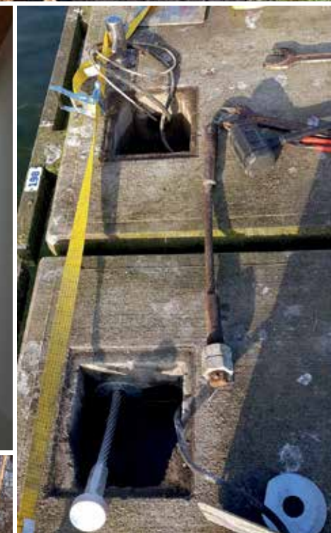
Befestigungen der Schwimmsteg
